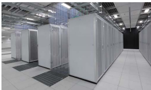
▲コンピュータエリア(ダブルデッキ上層:サーバ機器設置)
