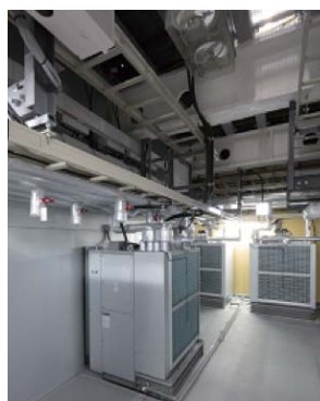
▲メンテナンスエリア(ダブルデッキ下層:空調設備機器設置)
