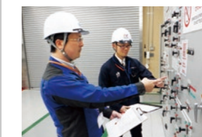
定期的な点検を行い安定稼働の 確認と予防保全を行う 各設備点検
